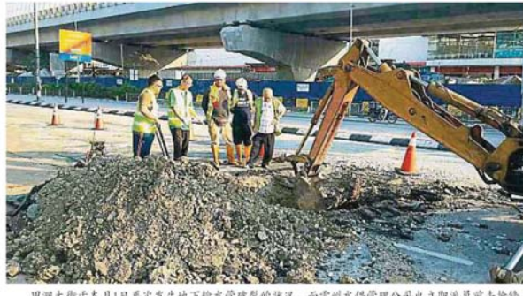
甲洞大街于本月1日再次发生地下输水管破裂的状况，而雪州水供管理公司也立即派员前去抢修。
