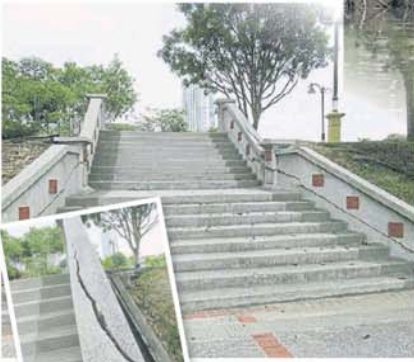
公园内的其中一个阶梯出现龟裂。
